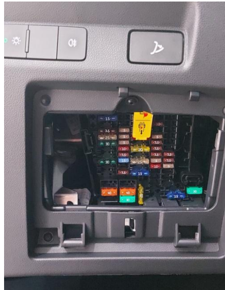
Figura 2. Caja de fusibles.
