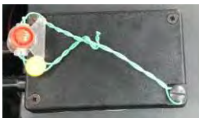
Fig. 4.1.1.1. Vista de una caja de conexiones y su precinto
