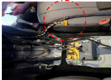
Detalle del cableado una vez desmontada la consola
