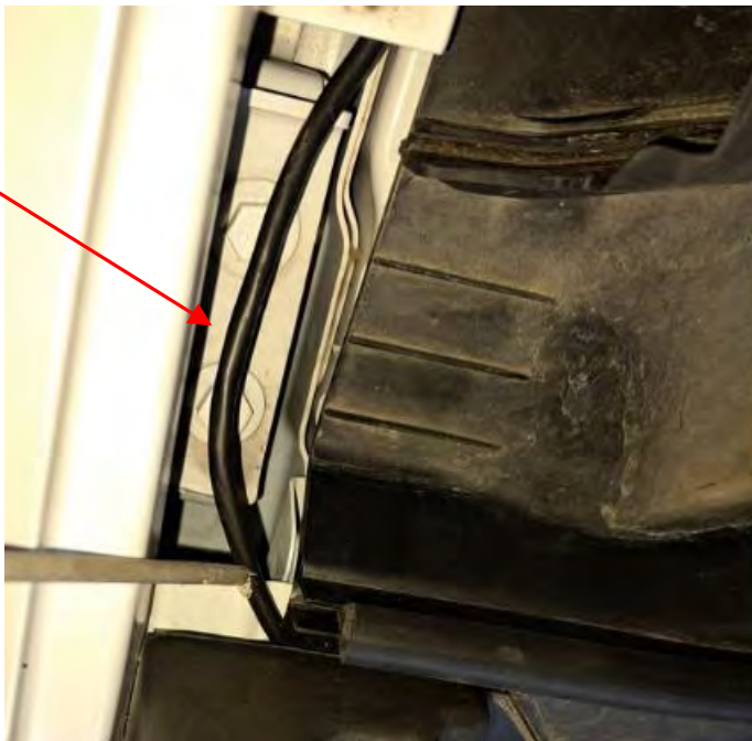
Cable del módulo
