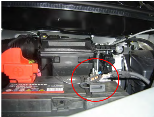
Fig. 4.1. Vista del fusible exterior
