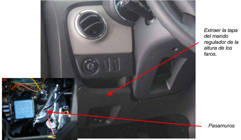
Fig. 1.3. Vista de la ubicación del pasamuros. Acceso de la instalación al habitáculo.
