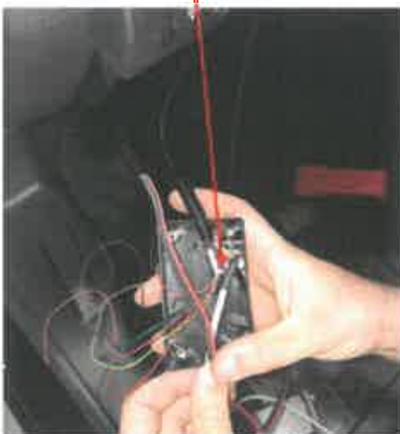
Conexiones caja adaptadora de señal
