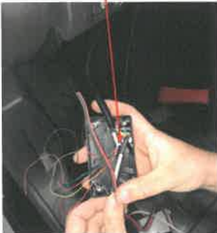
Conexiones caja adaptadora de señal
