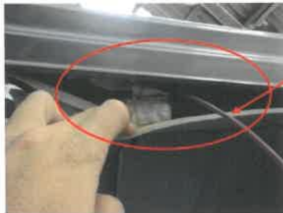
Cable módulo tarifario
