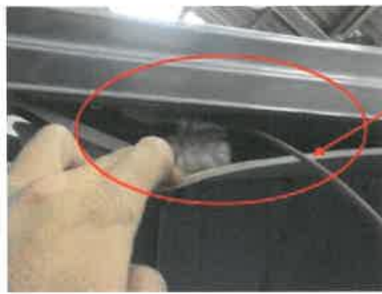
Cable módulo tarifario
