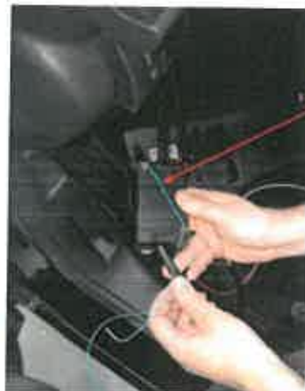
Precintado caja adaptadora de señal
