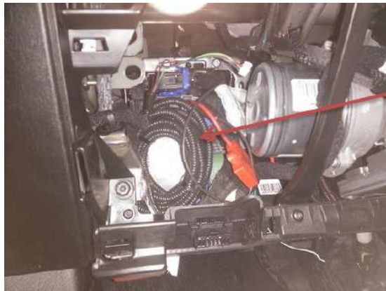
Manguera blindada Tubo corrugado de la instalación
