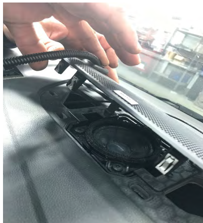
Fig. 4.2. Vista del paso de la manguera al habitáculo
