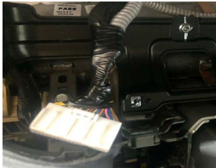
Fig. 1.5. Detalle del montaje final de la toma de señal y paso de manguera blindada por detrás del cuadro.
