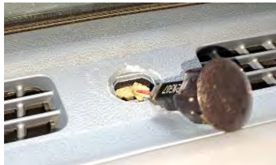
Fig. 4.1.3. Tapón extraído para paso de manguera blindada.
