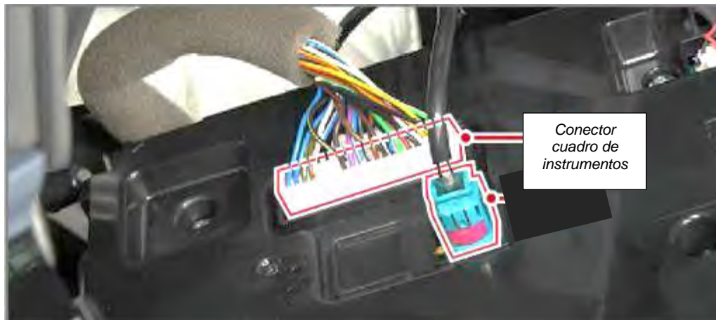
Fig. 1.1. Vista del Conector del cuadro de instrumentos.
