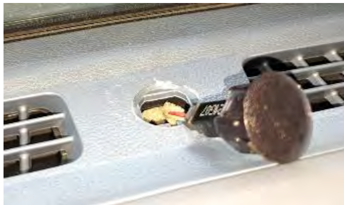
Fig. 4.1.3. Tapón extraído para paso de manguera blindada.
