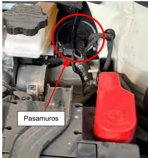
Fig. 2.1. Detalle pasamuros desde compartimento motor.
