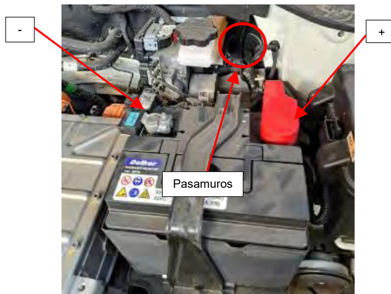
Fig. 4.1. Disposición de bornes de batería y pasamuros.
