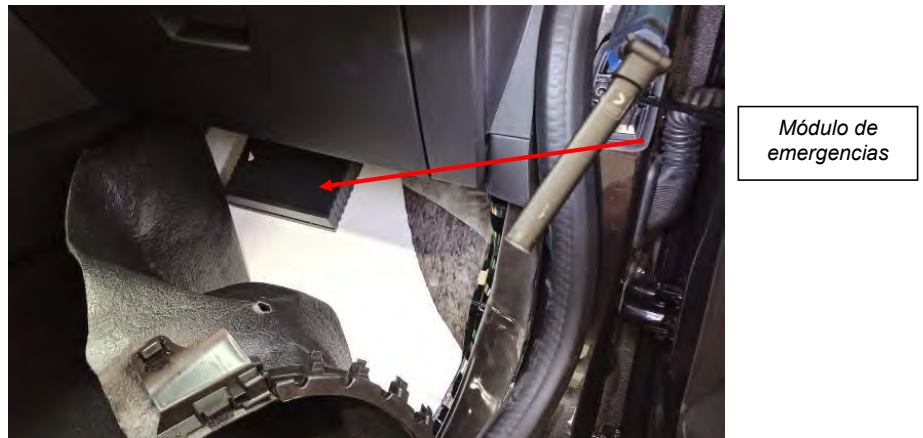
Fig. 7.2. Vista del emplazamiento del módulo de emergencias bajo el guarnecido.
