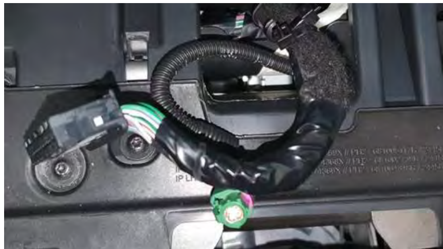
Fig. 2.2.3. Detalle conexión cable y manguera blindada al conector 247
