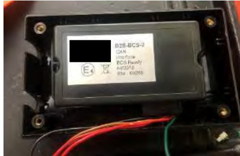
Fig. 3.2.2. Ejemplo de caja convertora de impulsos instalada dentro de la caja de conexiones
