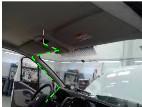
Fig. 9.1.3. Vista paso del cableado por el interior del techo hacia la caja adaptadora.
