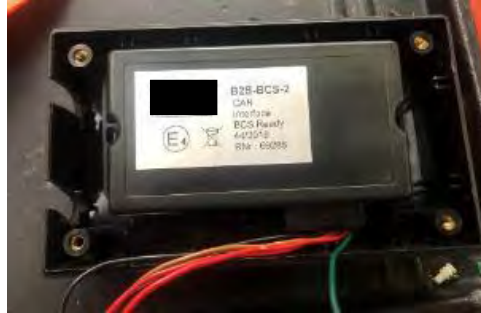
Fig. 3.2. Ejemplo de caja convertora de impulsos instalada dentro de la caja de conexiones
