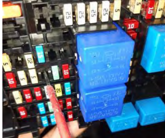
Fig. 2.3. Detalle de la Caja de Fusibles, indicando Nº 23
