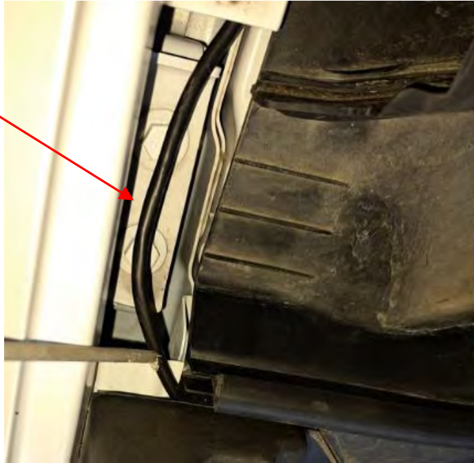
Cable del módulo
