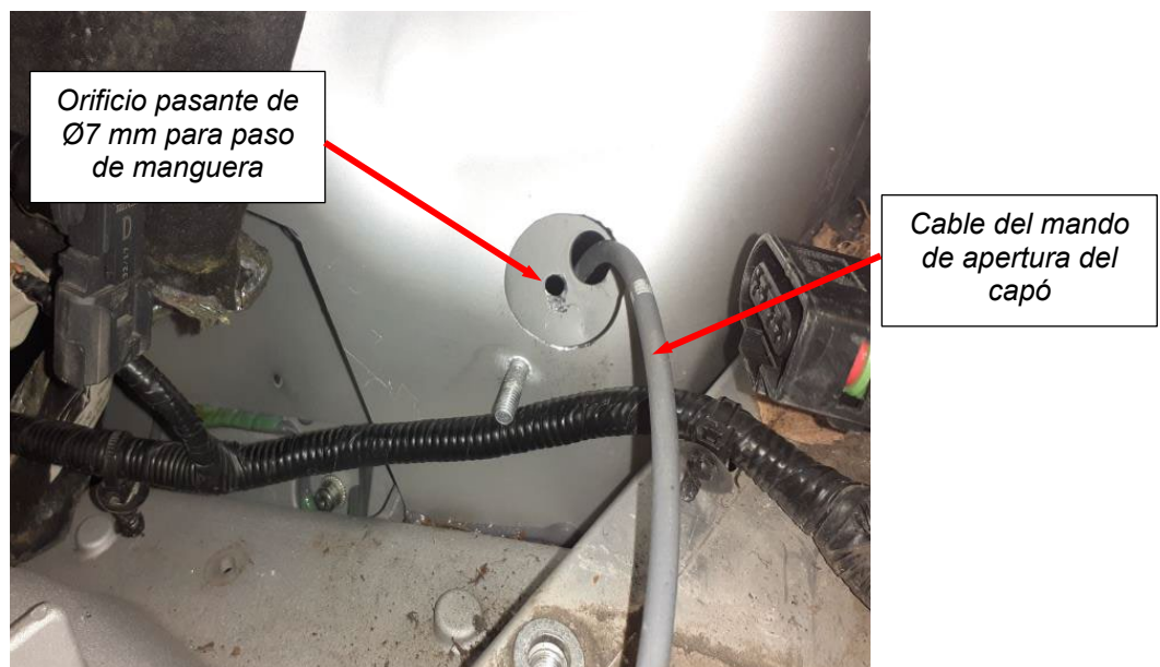
Fig. 1.13. Vista del pasamuros, lado motor.
