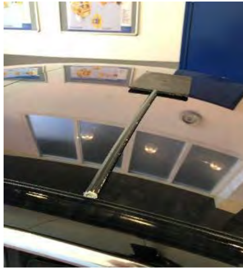
Vista de cable en canaleta autoadhesiva, módulo desplazado
