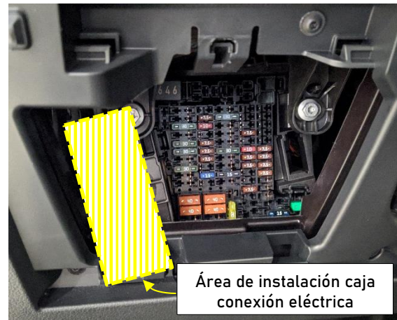
Figura 4. Área de instalación caja conexión eléctrica.
