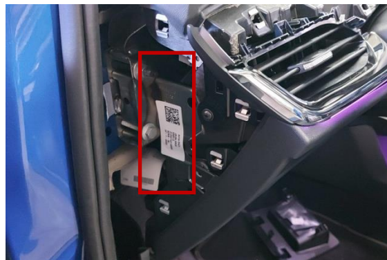
Figura 4. Ubicación caja de conexiones.
