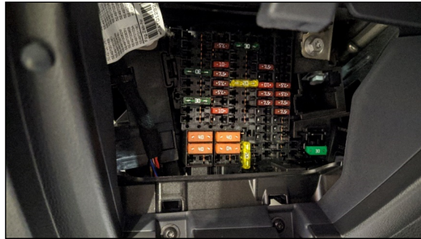
Figura 2. Caja de fusibles.
