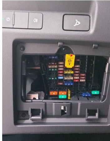
Figura 2. Caja de fusibles.
