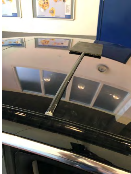
Vista de cable en canaleta autoadhesiva, módulo desplazado
