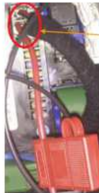
Conexión positivo con cinta protectora y fusible
