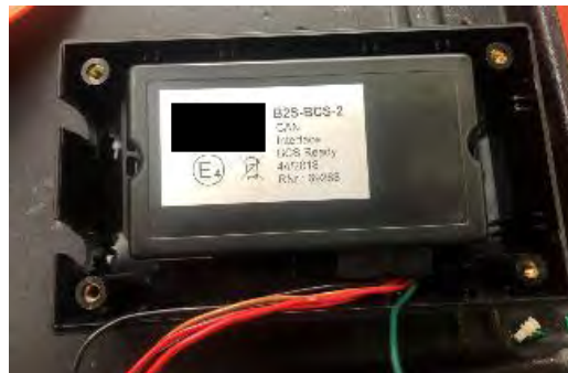
Fig. 3.1.2. Ejemplo de Convertora de impulsos instalada dentro de la caja de conexiones
