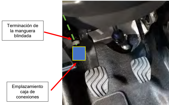
Fig. 3.1.1. Vista de la terminación de la manguera blindada puesta por el concesionario
