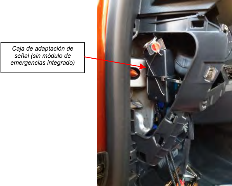
Fig. 3.3. Vista del compartimento lateral con la caja adaptadora de señal y detalle de precintos.
