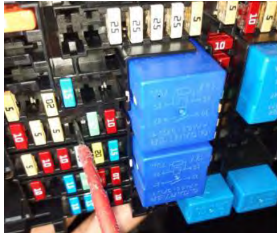
Fig. 2.6. Detalle de la Caja de Fusibles, indicando N° 23
