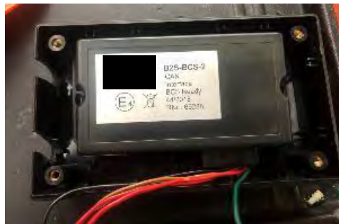
Fig. 3.1.2. Ejemplo de caja convertora de impulsos instalada dentro de la caja de conexiones
