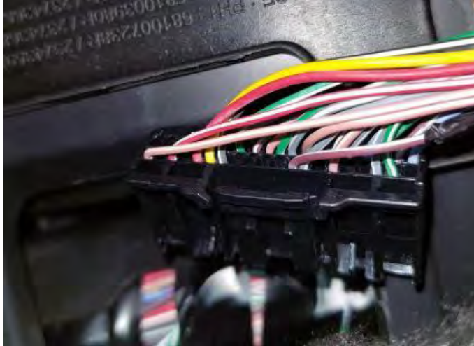
Fig. 1.3. Vista del conector 247 del cuadro de instrumentos
