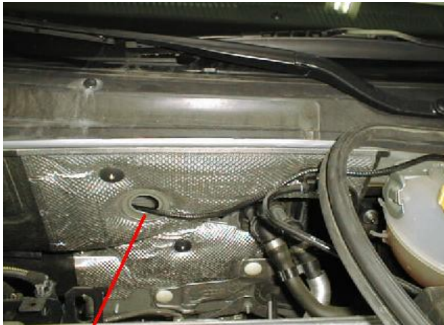
Paso en el tabique por el que se accede a la zona intermedia del vienteaguas
