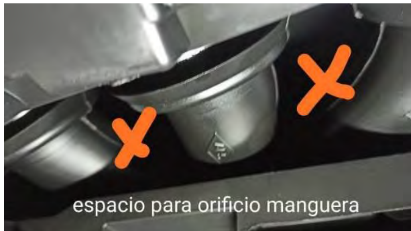
Fig. 4.3. Vista de las zonas de paso entre las toberas de los aireadores
