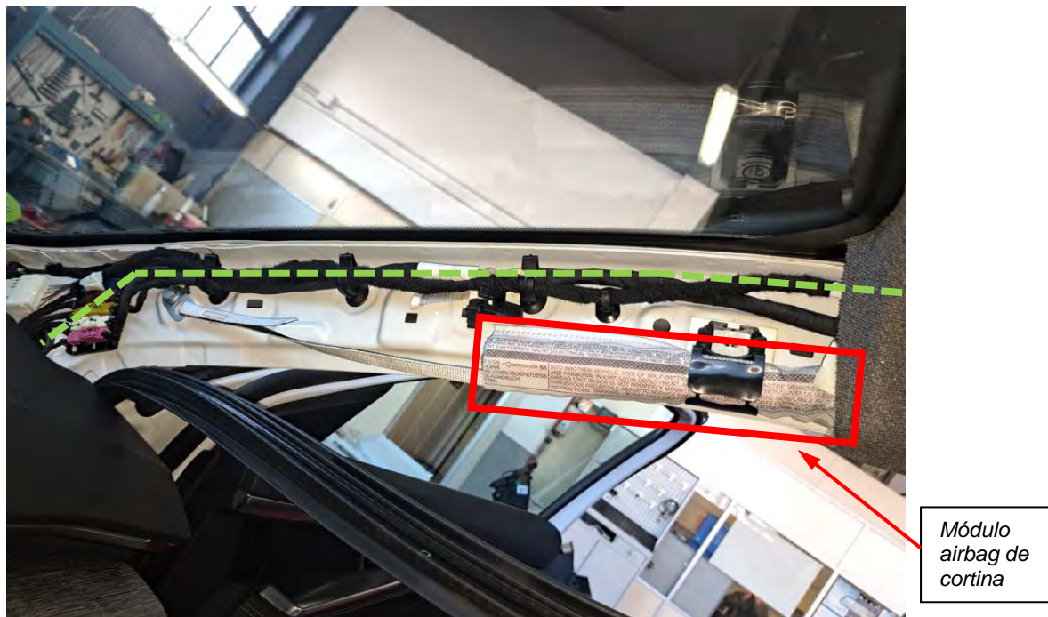
Fig. 6.2.3. Recorrido de los cables por el interior pilar A derecho.
